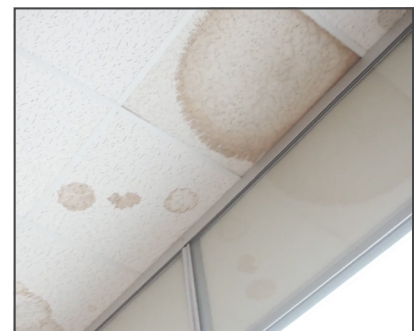
El deterioro de ciertas secciones de la cubierta ha provocado filtraciones y daños en los techos.
