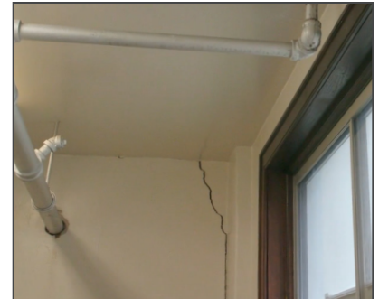
La filtración de agua ha provocado fisuras estructurales.
