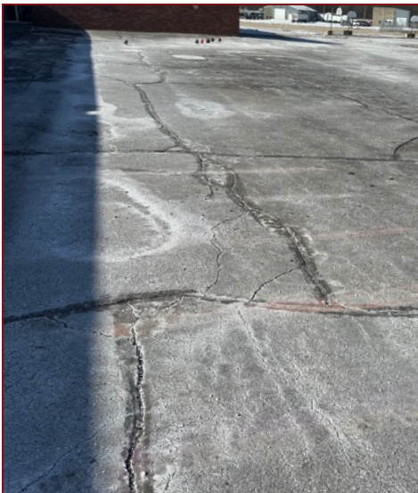
El estacionamiento trasero de la escuela primaria se está deteriorando; presenta pavimento agrietado y problemas de drenaje.
