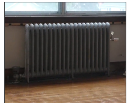
Los radiadores de las aulas han sufrido fugas, lo que ha dañado las vigas de soporte en la tercera planta y ha dejado los espacios inutilizables.
