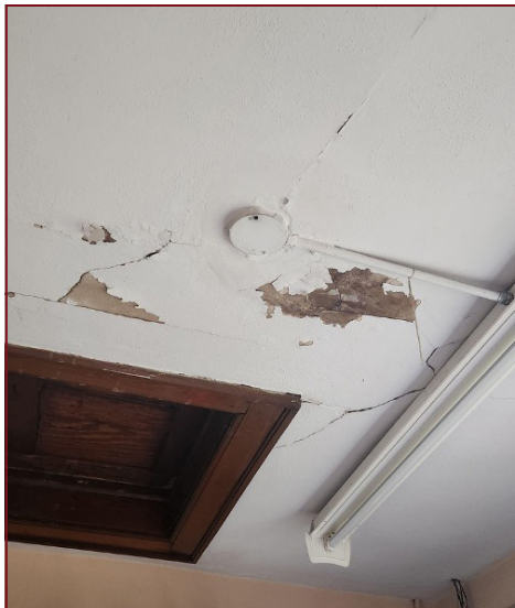
El techo presenta daños importantes por agua.
