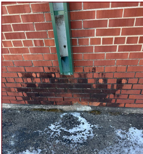
La acumulación de humedad ha manchado y decolorido la mampostería de ladrillo en la parte inferior. Asimismo, un drenaje inadecuado ha provocado el deterioro de la superficie y la aparición de residuos en el pavimento situado en la base del muro.
