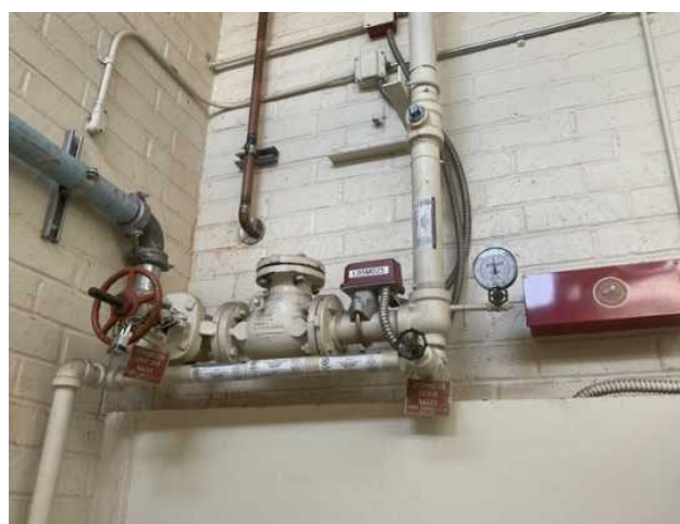
24 - FIRE SPRINKLER RISER
