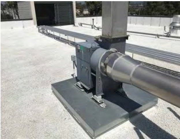
33 – ROOFTOP EXHAUST FAN
