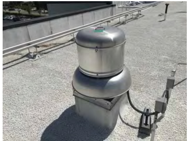
34 – ROOFTOP EXHAUST FAN
