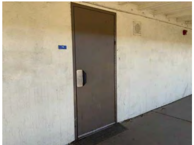
28 - EXTERIOR STEEL DOOR
