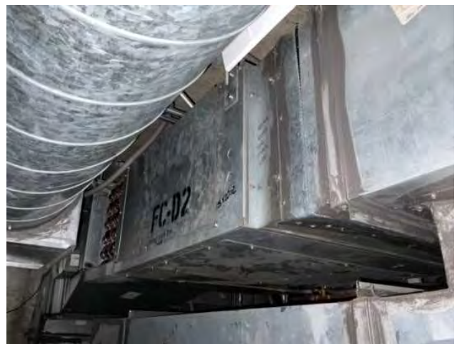
30 - FAN COIL UNIT
