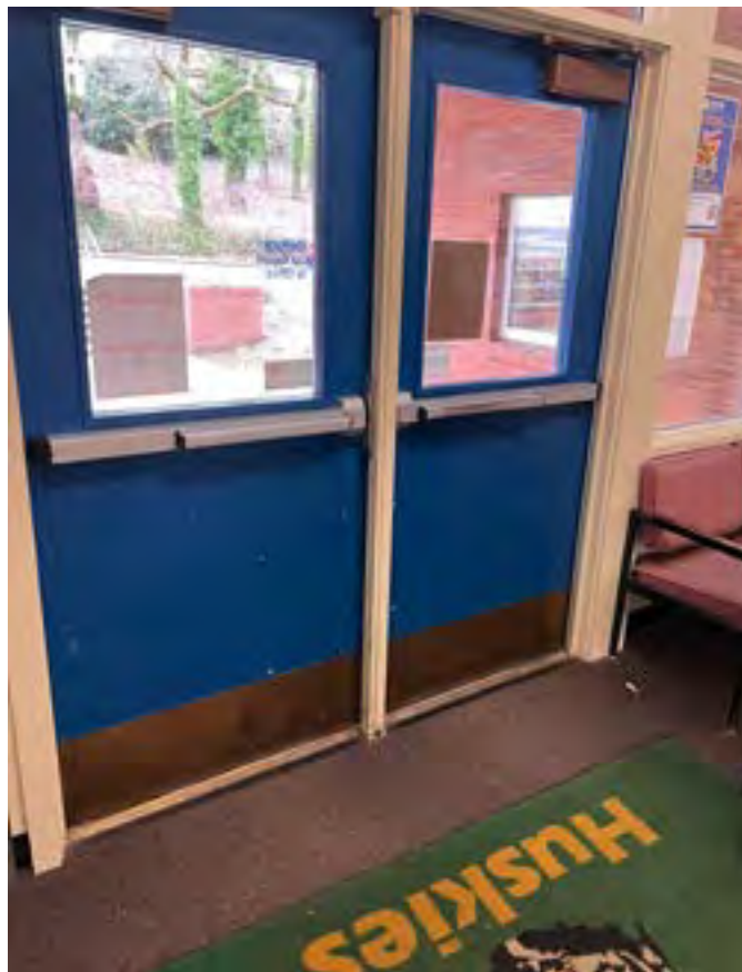
La entrada principal no cuenta con un vestíbulo de acceso seguro
