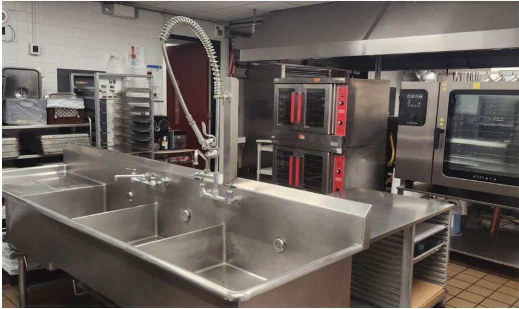
Equipamiento de cocina nuevo y sustitución de la campana extractora (el equipamiento existente se muestra aquí).
