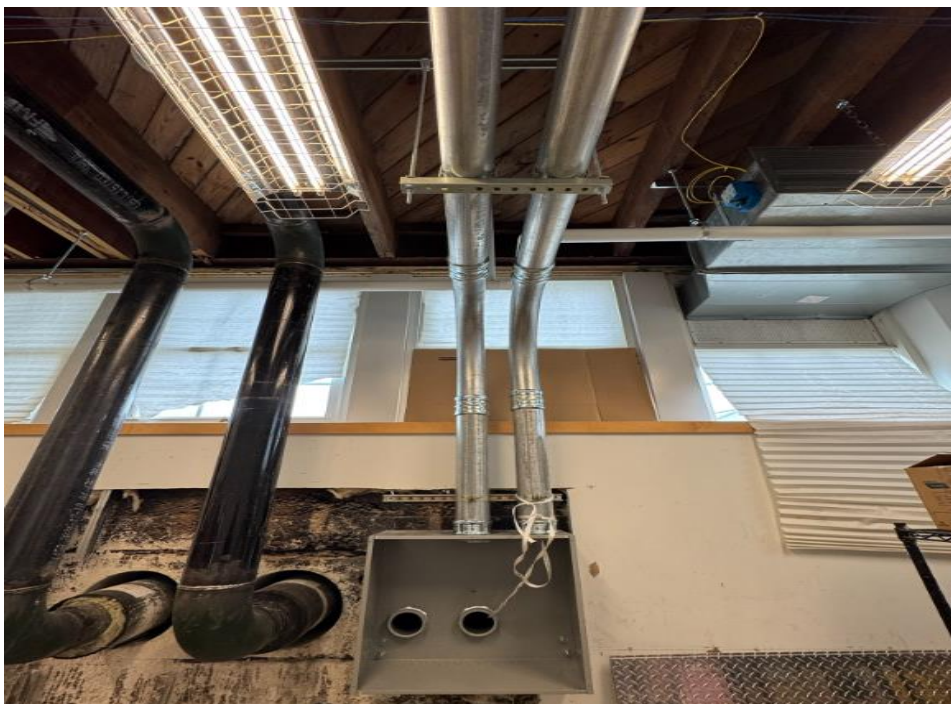
Hempstead IAQ – Prospect ES Conduit Runs
