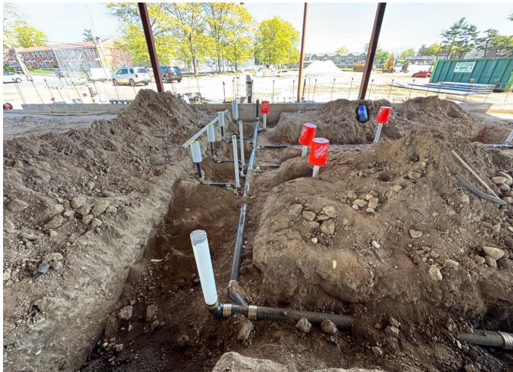
Hempstead ABGS MS – UG Drain Piping
