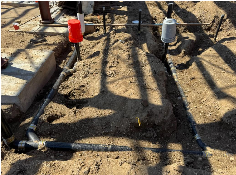
Hempstead ABGS MS – UG Drain Piping
