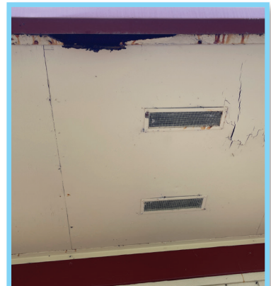
EL TECHO DE LA ESCUELA PRIMARIA ELKHORN ESTÁ DETERIORADO.
