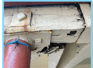
VIGAS DE MADERA CON MADERA EN DESCOMPOSICIÓN EN LA ESCUELA PRIMARIA PRUNEDALE.
