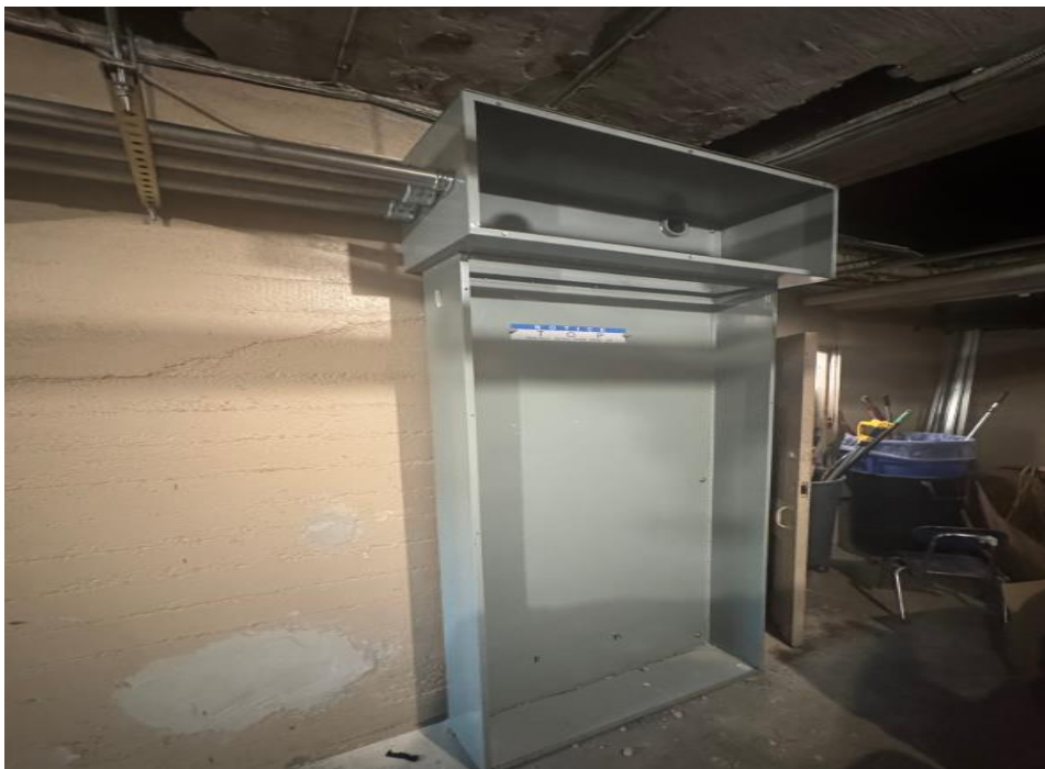
Hempstead IAQ – McNeil ES Conduit Runs
