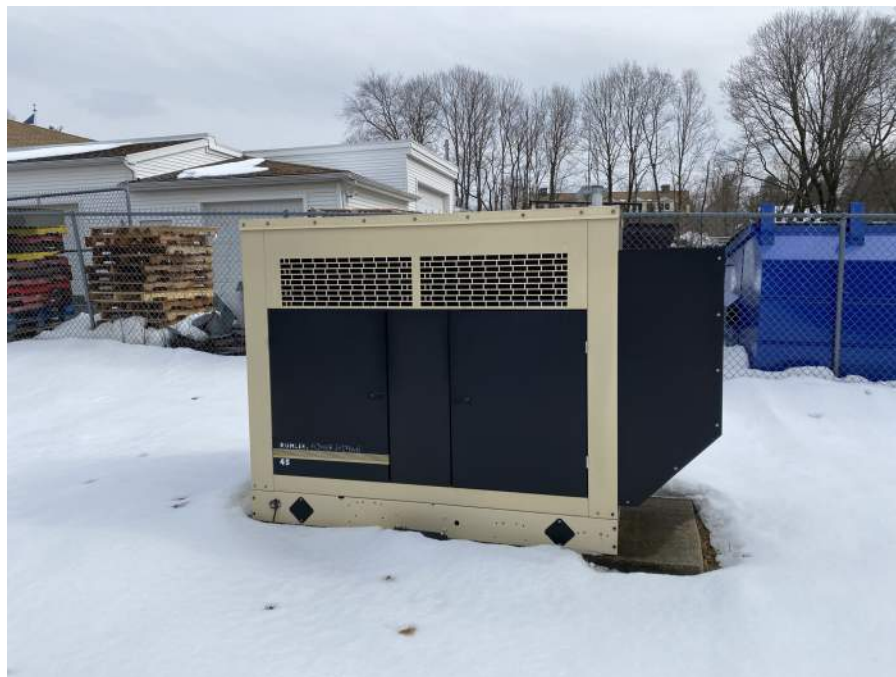
● D2. 40: Standby Generator
