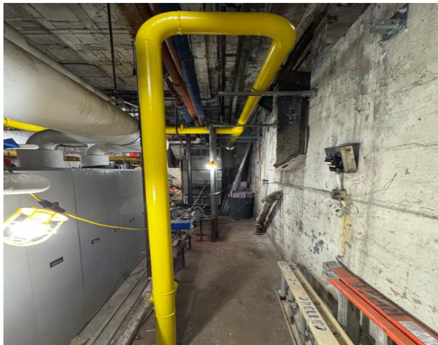
Hempstead ABGS MS – New Gas Feed
