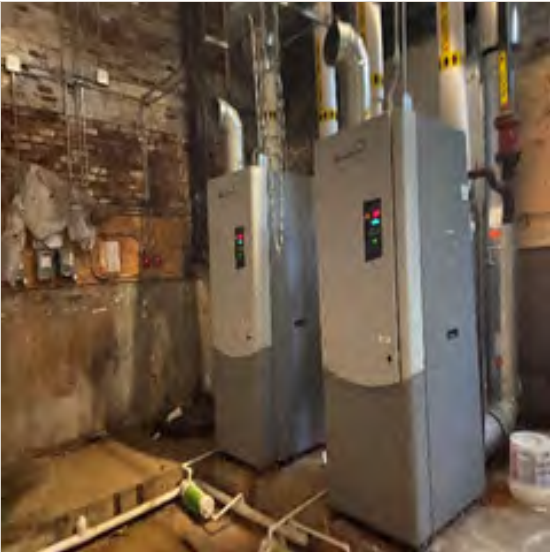
M-1: Condensing Boilers
