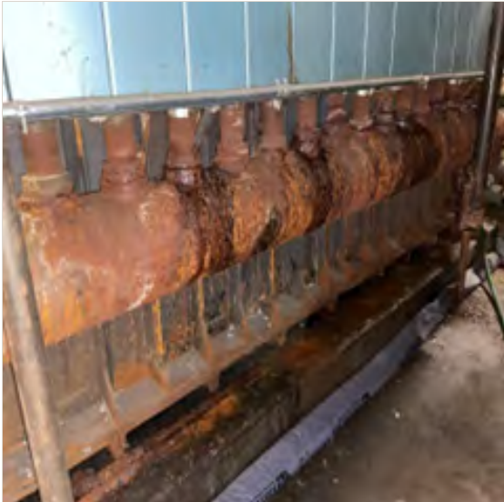
M-1: Vintage Boiler
