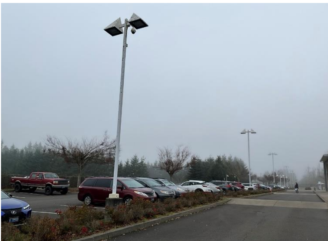
5 – SITE LIGHT POLE
