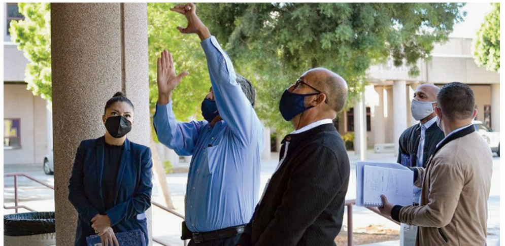
Senator Lena Gonzalez observes a faulty structure at the vacated Lynwood High School Imperial Campus on Oct. 26. La Senadora Lena Gonzalez observa una estructura defectuosa en el plantel desocupado de la preparatoria Lynwood Imperial el 26 de octubre.
