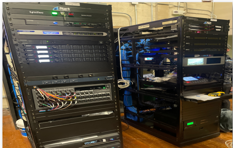
WBS - Auditorium AV Racks
