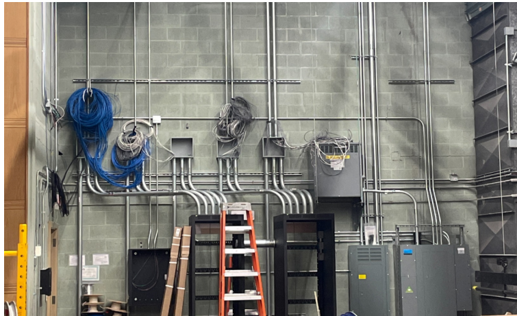
WBS - Auditorium AV Racks & Conduit Runs
