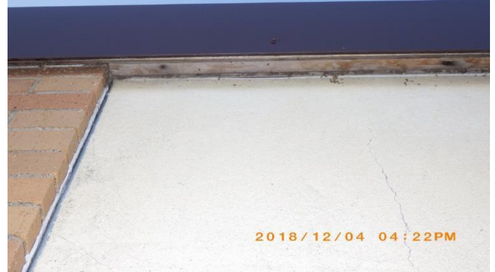
Stucco Above Doors
