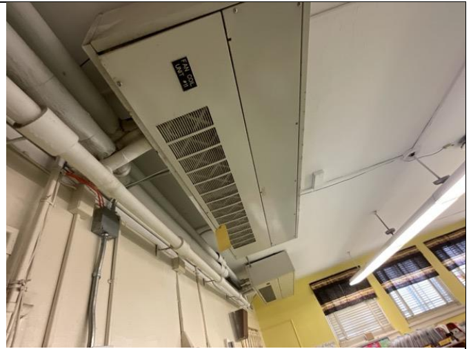
14 - FAN COIL UNIT
