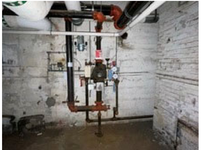
20 - FIRE SPRINKLER RISERS
