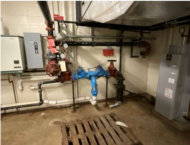
19 - FIRE SPRINKLER RISER
