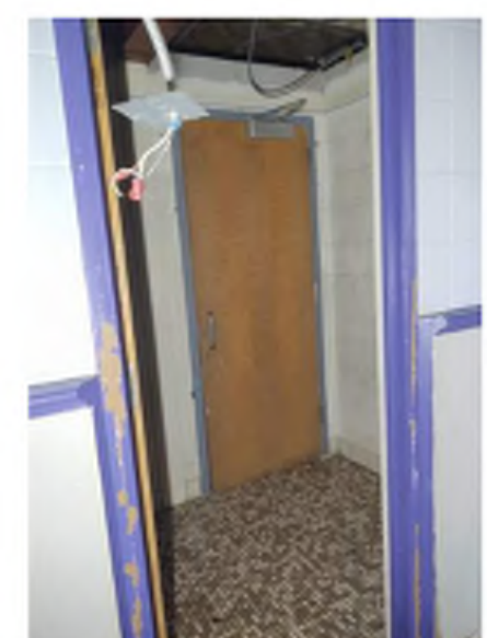
9A. NON-COMPLIANT VESTIBULE/DOORS
