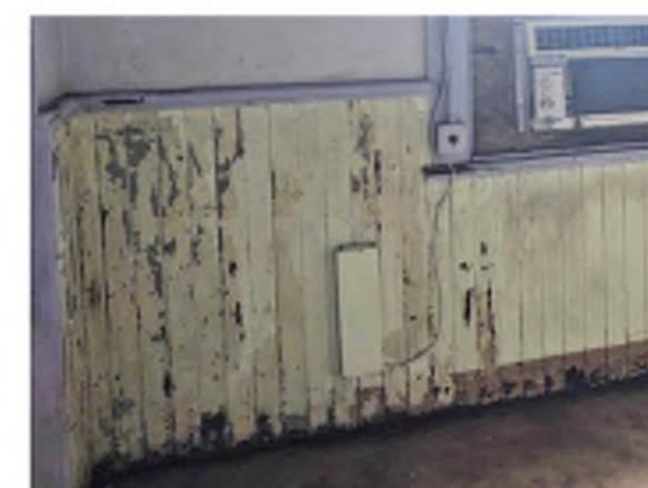
5E - DAMAGED/PEELING PAINT
