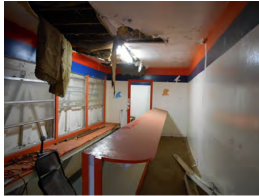
Canutilo_MS Press Box, abandoned interior
