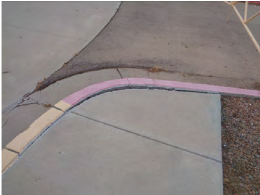
Garcia_ES Sidewalk settlement, trip hazard,
