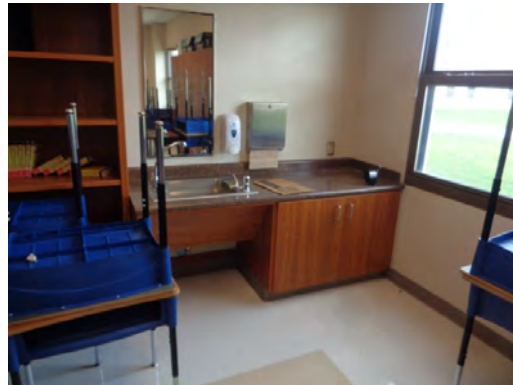
Garcia_ES Wall damage under windows
