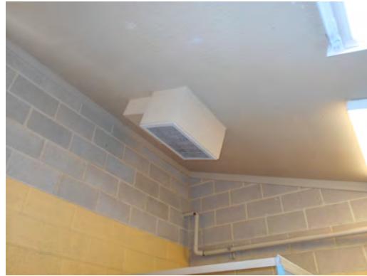
Canutillo ES_Restroom exhaust deficient
