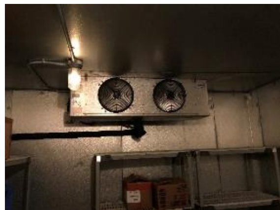
Walk-in Evaporator Fan
