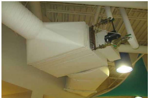
#42: VARIABLE AIR VOLUME (VAV) UNIT
