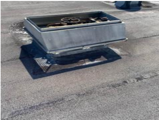
Roof exhaust fan
