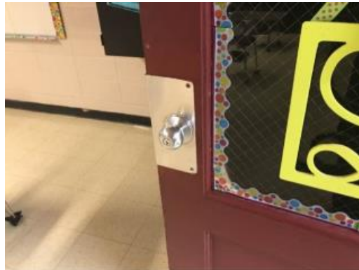
Door hardware not ADA compliant
