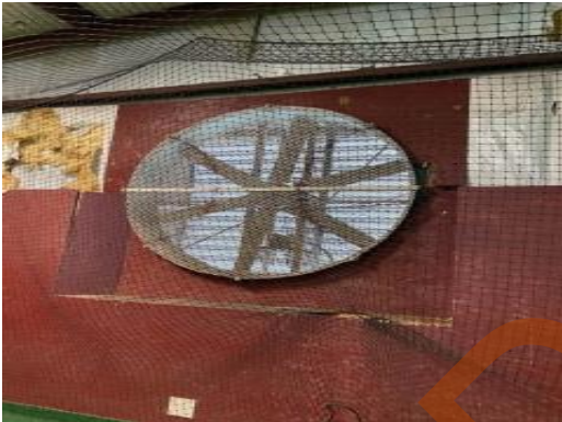
Noisy wall exhaust fan
