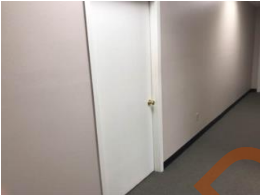
No ADA compliant door hardware
