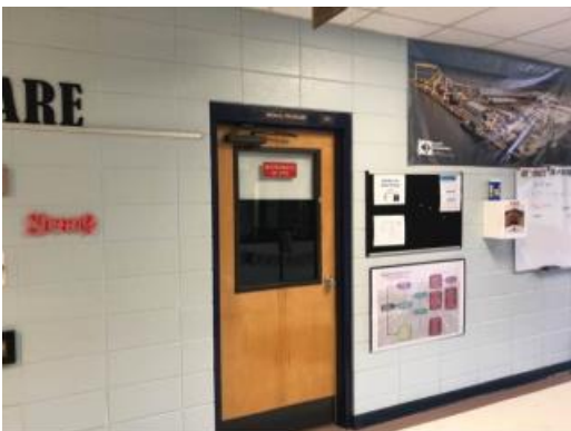
Door hardware not ADA compliant
