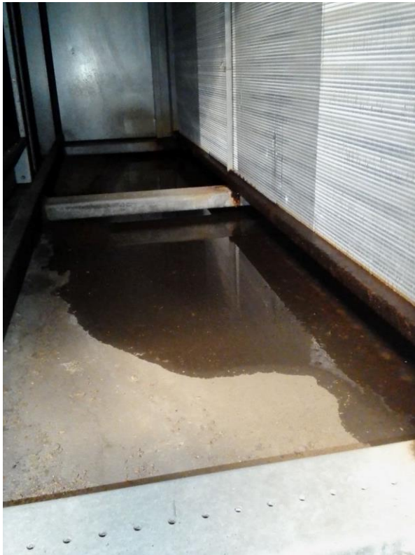
AHU-08 Drain Pans
