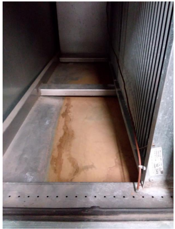
AHU_04 Drain Pans
