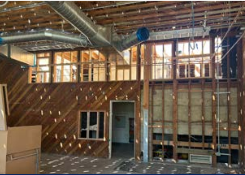
EP Birney HVAC/Modernización
