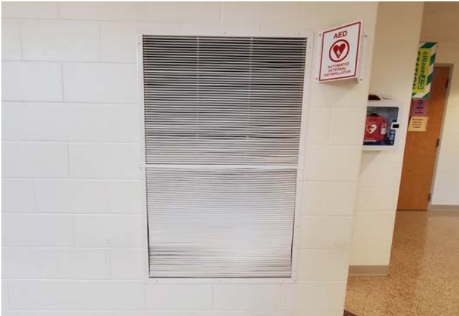
DAMAGED LOW RETURN GRILLE AT COMMONS
