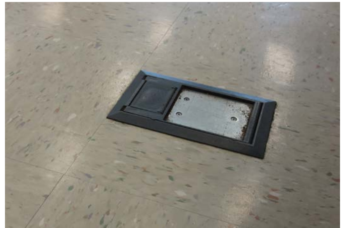
UNUSED FLOOR BOX (TYP.)
