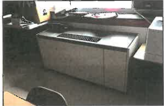
Arendtsville ES Existing Unit Ventilator
