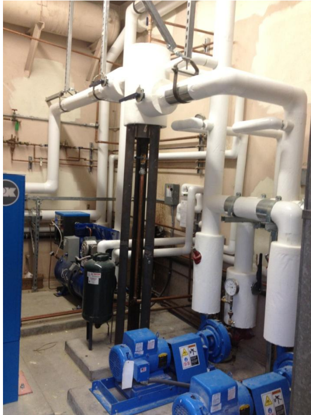
Kettering ES Boilers
