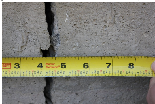
(d) wide crack opening
