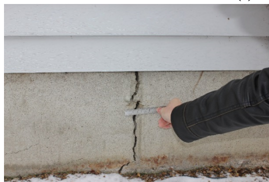
(d) wide crack opening
