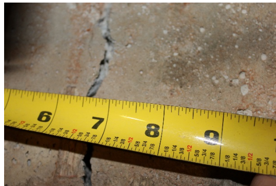
(d) wide crack opening
