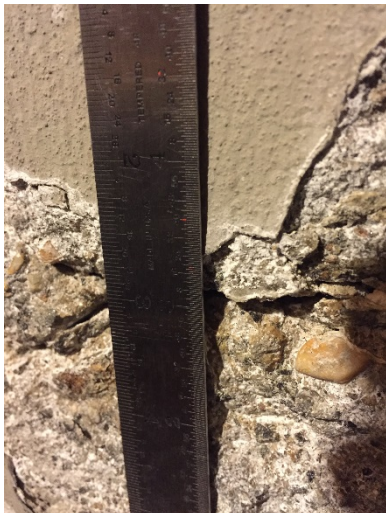
(d) wide crack opening
