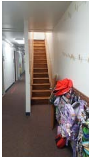
Non Compliant Stairwell
